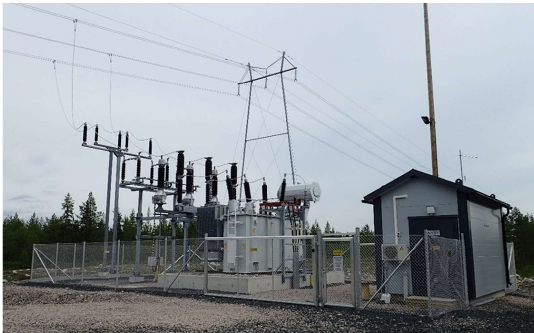
Bild 17. Exempel på en elstation i en vindkraftspark (Bild: FCG).
