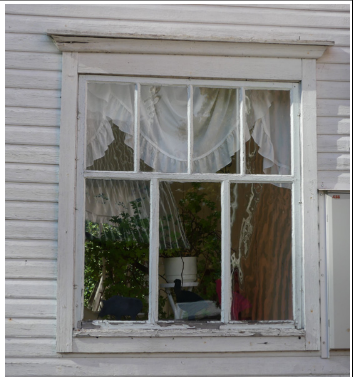
Odelat fönster i första våningen.
