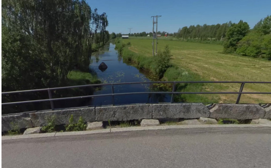
Kuva 13. Tuovilan kivisilta, esimerkikohde kaiteiden korottamisesta.
