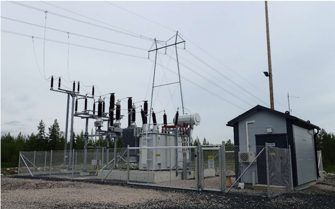
Kuva 17. Esimerkki tuulivoimapuiston sähköasemasta (Kuva: FCG).
