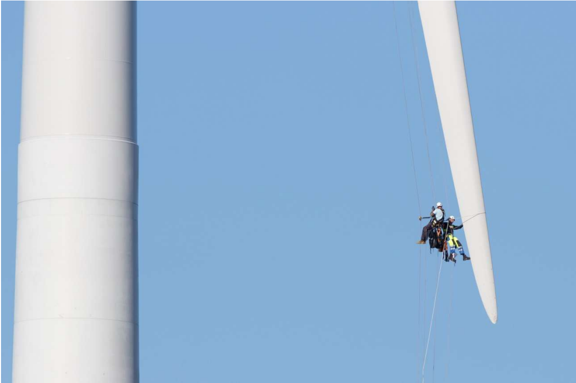
Kuva 26. Tuulivoimalan huoltotoimenpiteitä (Kuva: FCG).
